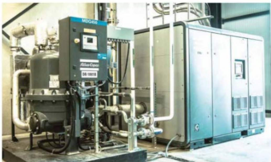
De MDG450 adsorptiedrogers staan pal naast de olievrije schroefcompressoren en gebruiken compressor-warmte voor de regeneratie van het droogmiddel.
