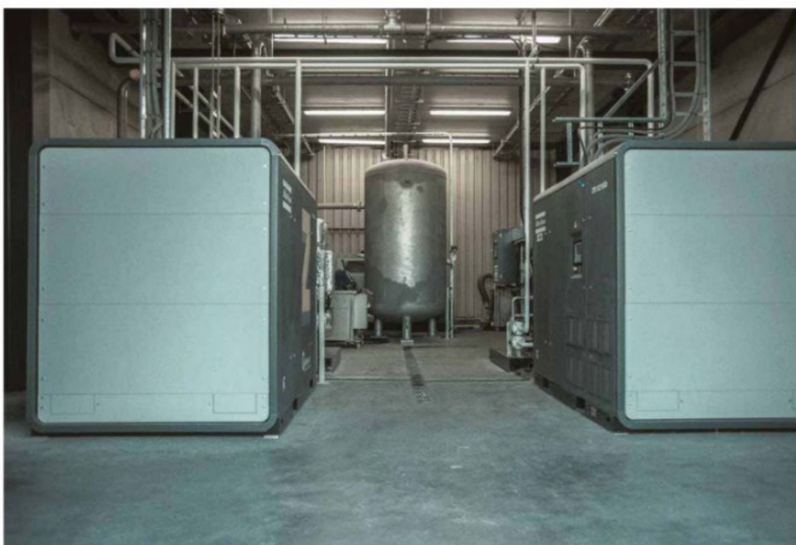
In de nieuwe fabriek van Trinseo in Hoek staat een redundante persluchtinstallatie, bestaande uit twee olievrije VSD schroefcompressoren met achter elke compressor een 'Heat of Compression' adsorptiedroger.
